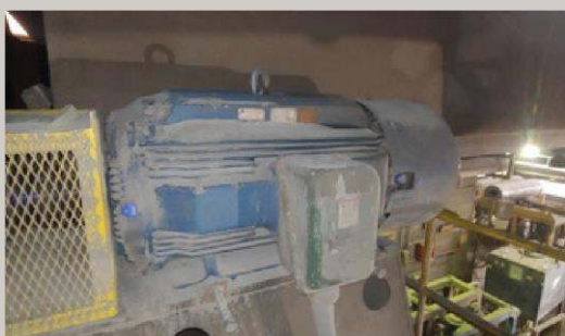
A LADLE HOLE FAN - MOTOR
